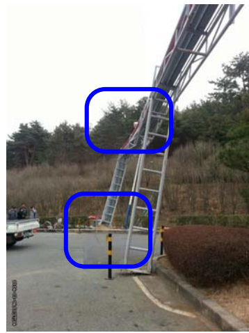
오버브릿지 및 배관 2개소 변형 확인
