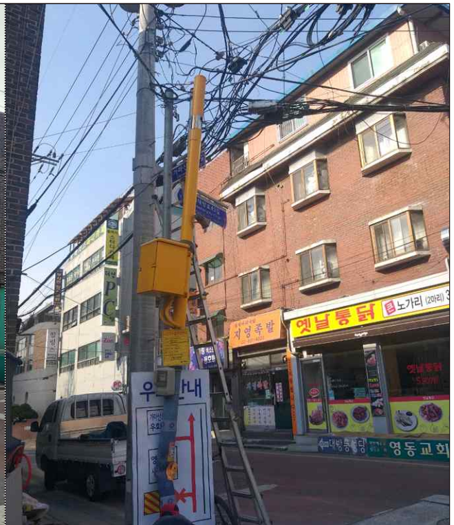
사고 현장 및 Pole 파손상태
