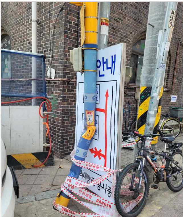
사고 현장 및 Pole 파손상태
