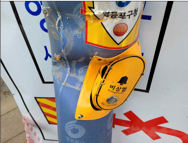
비상벨 세트 + 불법부착물 시트 파손
