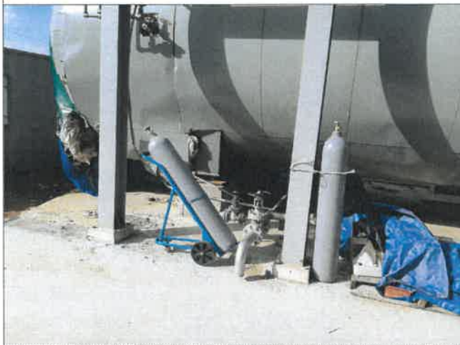
스팀탱크 하단부 파손상태
