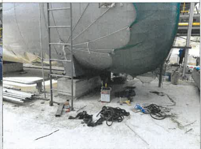
스팀탱크 하단부 파손상태
