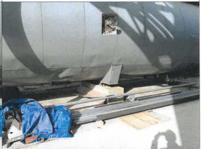
스팀탱크 하단부 파손상태
