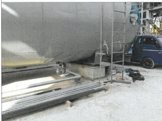
스팀탱크 하단부 파손상태
